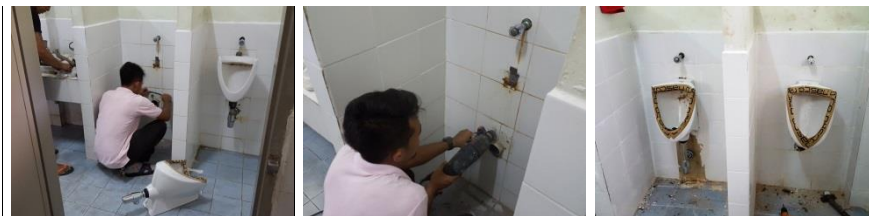
๔.๗ เปลี่ยนอ่างล้างหน้าตึกพักชายที่ ๕ ป้องกันอันตรายจากอ่างล้างหน้าแตกร้าว
