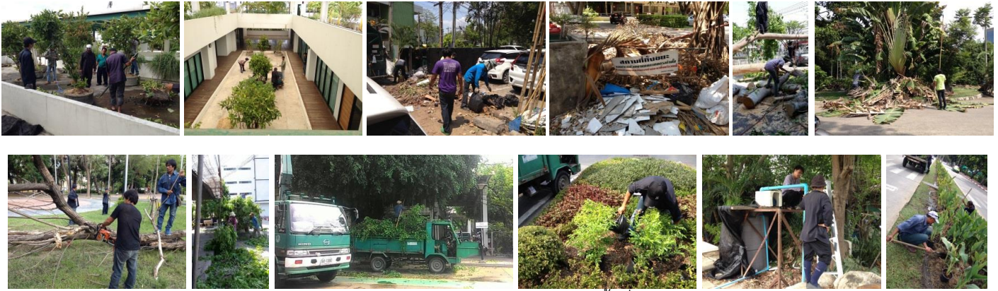
งานซ่อมบำรุง ปรับปรุง/ซ่อมแซมระบบไฟแสงสว่าง ระบบสาธารณูปโภค อาคารและพื้นที่ส่วนกลาง
