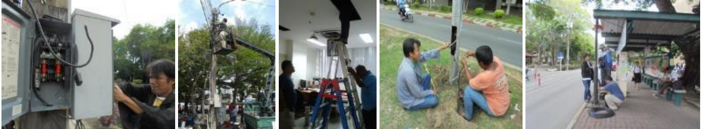
งานอาคารและสถานที่ พัฒนาระบบไฟฟ้าและอุปกรณ์ไฟฟ้า ระบบเครื่องปรับอากาศและเครื่องทำน้ำเย็น ระบบประปาและเปลี่ยนสุขภัณฑ์ห้องสุขา อุปกรณ์โสตทัศนูปกรณ์ และปรับปรุงสภาพแวดล้อมอาคารเรียนส่วนกลาง
