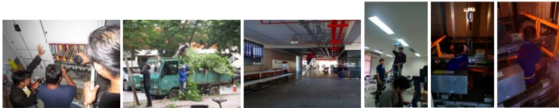
งานบำรุงรักษาอาคารกิจการนิสิต ดำเนินการ เปลี่ยนข้อต่อประปาแตก ซ่อมหลังคา เปลี่ยนพื้นไม้ไผ่เตียง ชุดวางท่อระบายน้ำทิ้ง เปลี่ยนหลอดไฟฟ้าส่องสว่าง ติดโคมไฟฟ้านีออนซ่อมแซมฝ้าเพดาน
