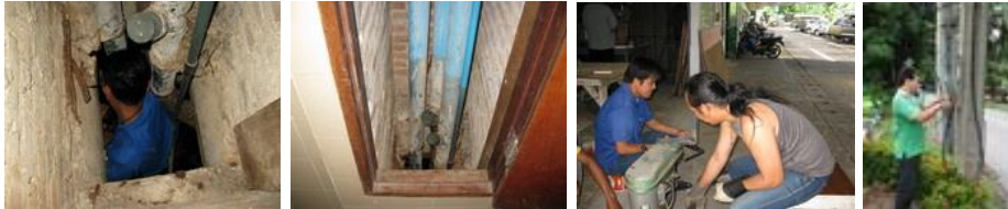
ที่มา: งานซ่อมบำรุง (๒๑ ก.ย.-๒๐ ต.ค. ๕๖)
