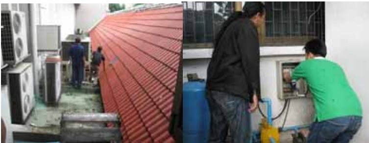
การดูแลซ่อมบำรุงระบบไฟฟ้า ประปา โทรศัพท์ พื้นที่ ส่วนกลาง มก.
