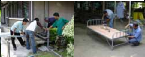
ดูแลบำรุงรักษา อาคารหอพักนิสิต เช่น ซ่อมระบบน้ำประปา ไฟฟ้า เตียงนอน มุ้งลวด ฯลฯ
